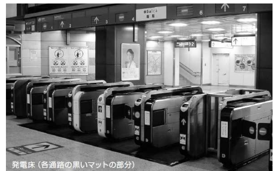
図3 2006年の東京駅丸の内北口改札の発電床実験
